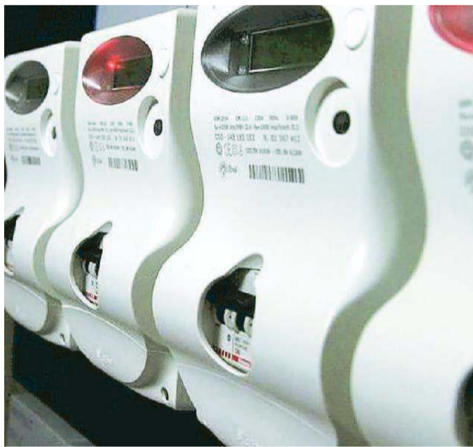
Contatori per la misurazione dei consumi di energia elettrica
